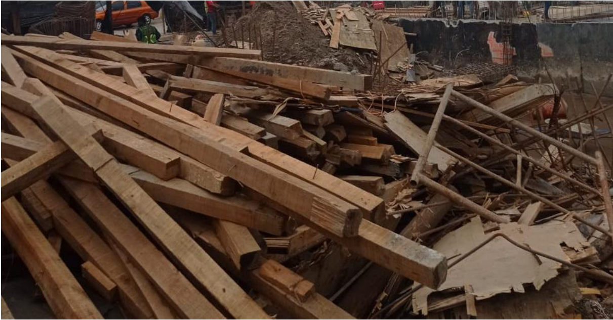
Imagen 5 Residuos de madera generados en obra.
