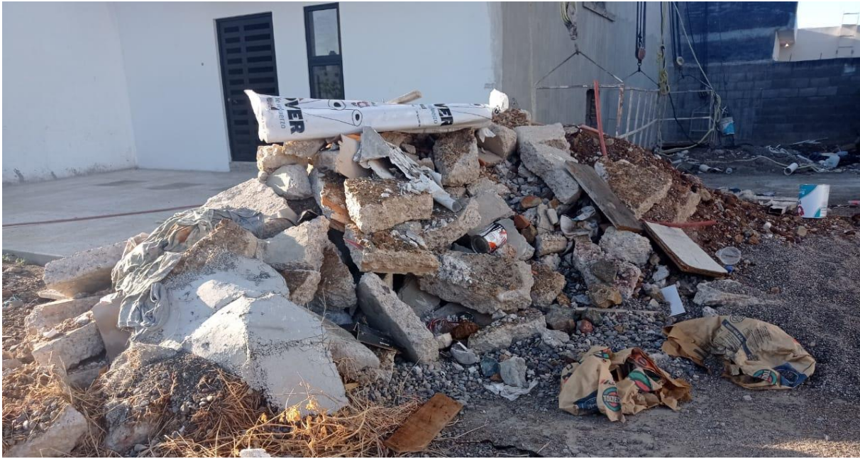
Imagen 7 Residuos de concreto, tierras y agregados mezclados que disturbaban el aspecto de las calles de las urbes.
