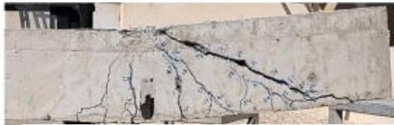
c) Viga con agregado natural con estribos
