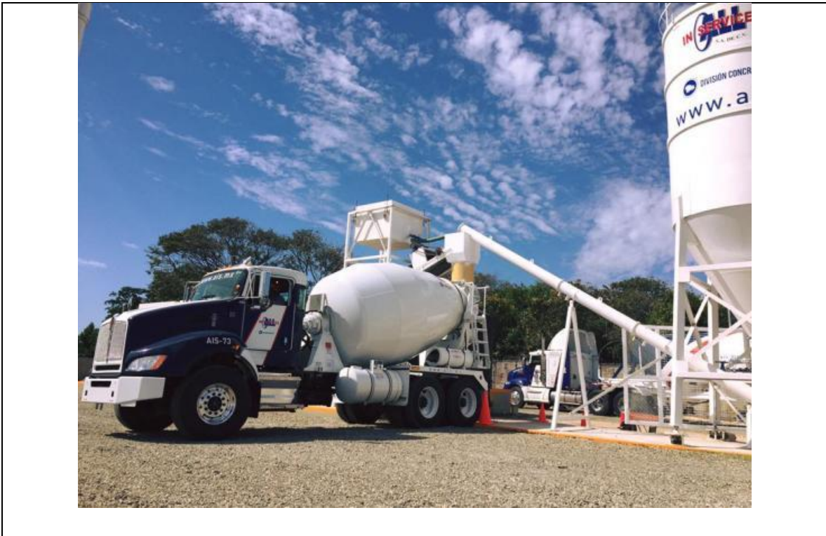
ILUSTRACIÓN 10. PLANTA DOSIFICADORA DE CEMENTO.
