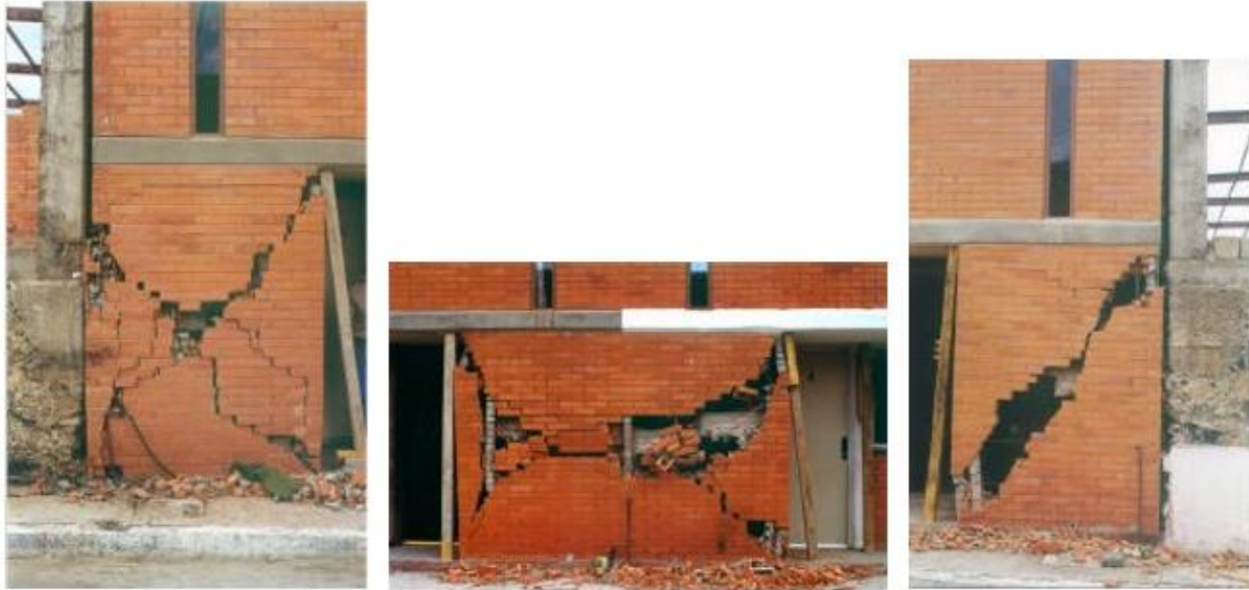
Figura 1.15 Daño de planta baja. Colegio de Ingenieros Civiles del Estado de Puebla (CICEPAC) 17
