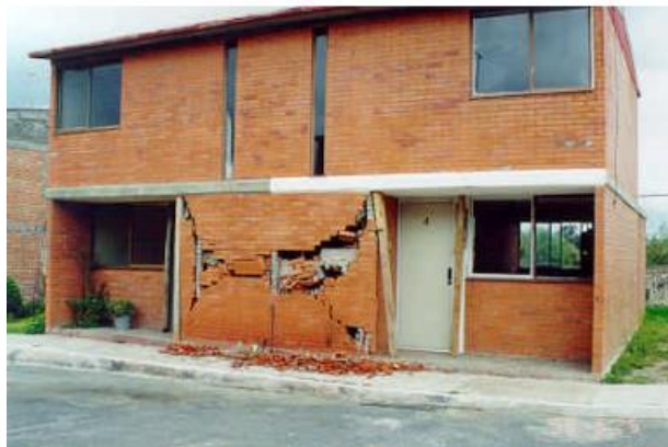
Figura 1.16 Daño en muro de fachada. Alcocer et al. (1999).
