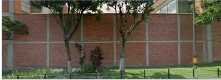
(a) Antes del colapso (no se muestran las perforaciones realizadas posteriormente)
