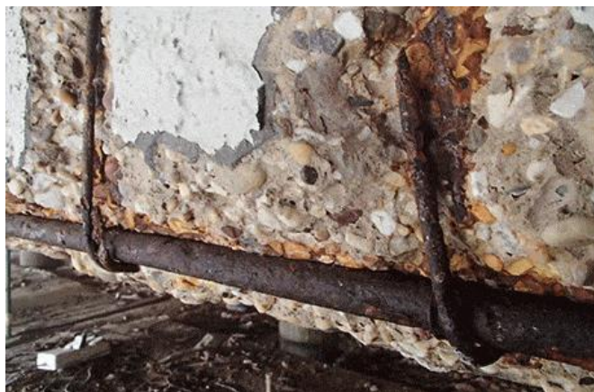
Figura 14. Corrosión del acero bajo el ataque de cloruros
