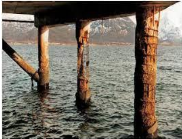
Figura 13. Deterioro del concreto debido a la exposición de un ambiente marino
