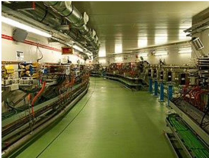
Figura 36. Vista del interior del túnel ALBA. Fuente: Wikipedia, disponible en: https://es.wikipedia.org/wiki/ALBA_%28sincrotr%C3%B3n%29
